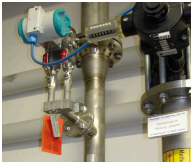
deltaflow do pomiaru biogazu.
