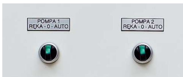
Przełączniki na drzwiach wewnętrznych
